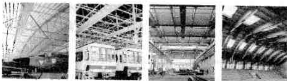
Рис. 1. Примеры установки водяных инфракрасных панелей на промышленных объектах
